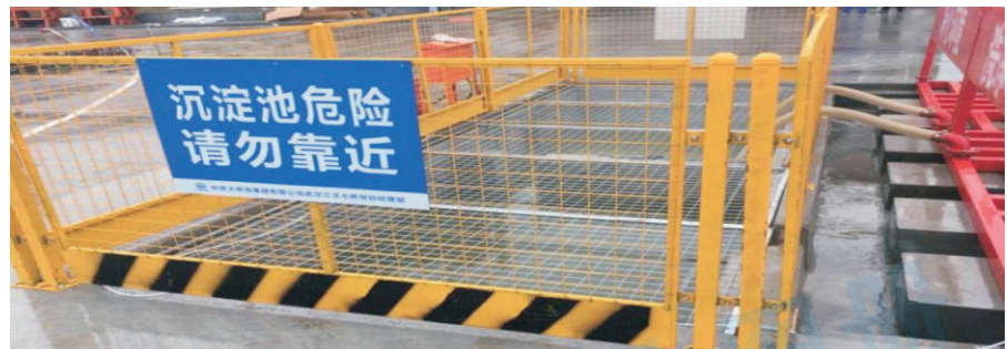
污水经沉淀池处理
