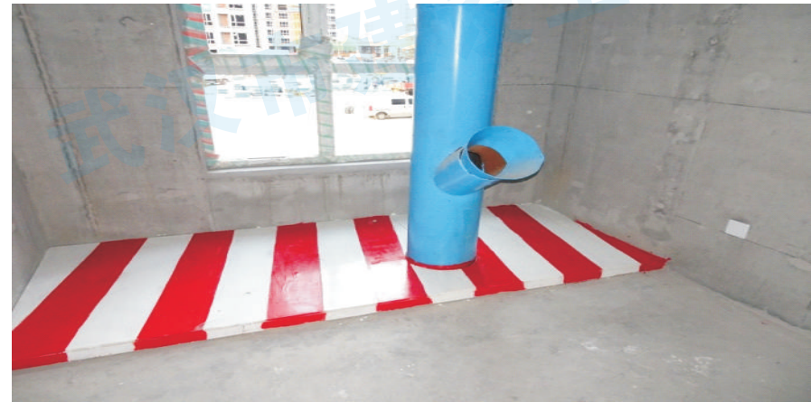
封闭式垃圾管道
